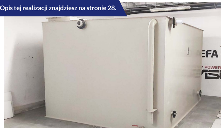
Zbiornik przeciwpożarowy 18 m 3 dla budynku biurowego
