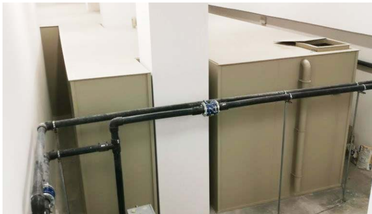
Zbiornik zapasu wody pitnej 162,5 m 3 dla nietypowej przestrzeni szpitala
