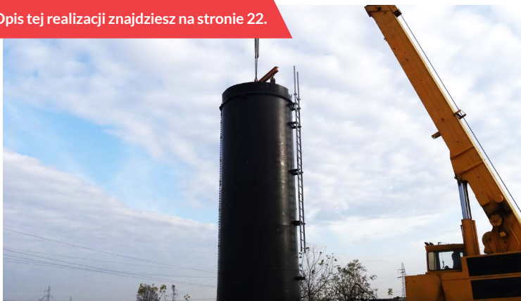
Zbiornik dwupłaszczowy 30 m 3 do magazynowania ługu sodowego 50%
