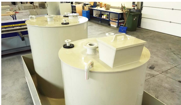
Zbiorniki procesowe w wannie ociekowej na stację koagulantów
