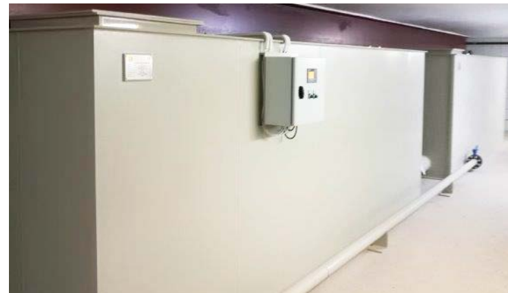
Zbiorniki zapasu wody do celów produkcyjno-myjących po 21 m 3 każdy
